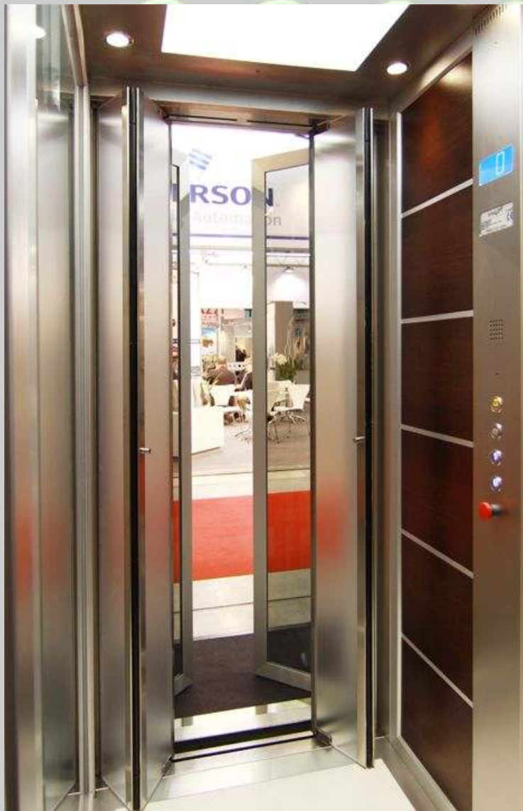
Porta di cabina a soffietto in fase di apertura.
